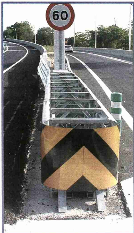
Protecciones en un guardarrail. MAFFRE
